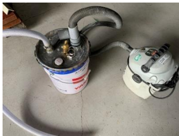
廃棄ペール缶を再利用した汚水ポンプ
